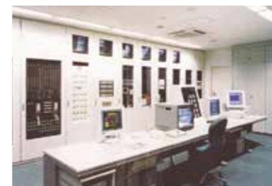
中央監視設備
