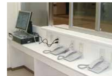
電話・LAN設備
