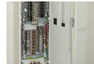
電灯分電盤・動力制御盤
