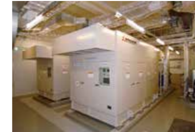
自家発電設備
