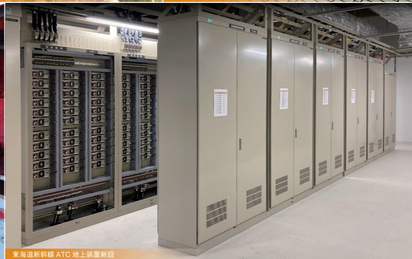
東海道新幹線 ATC 地上装置新設
