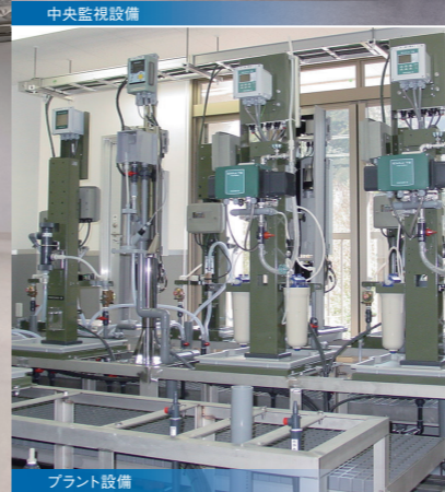
プラント設備
