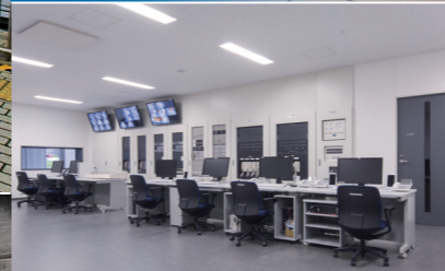
中央監視設備
